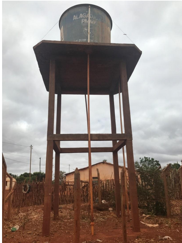
Figura 76 - Reservatório de água salobra do poço – Alagadiço/Mulungu
