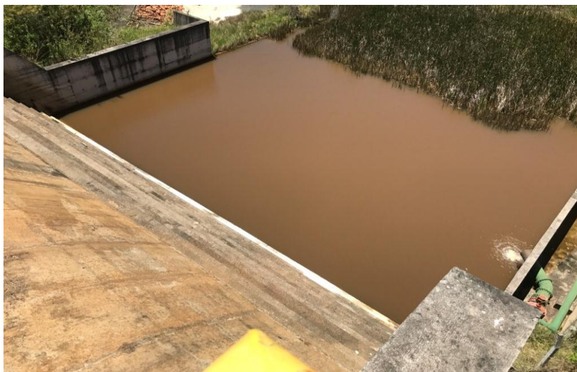
Figura 109 – Água de escape da Barragem Rio Tijuco – Juliana/Mulungu
