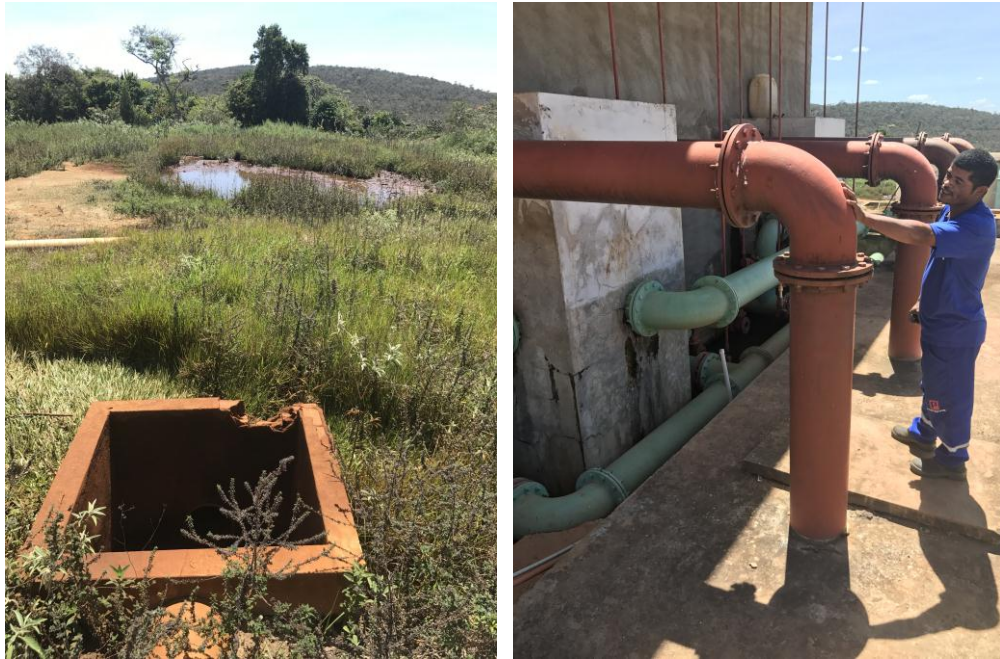
Figura 67 – Tubulação e leito de secagem do lodo – ETA Mulungu e Souto Soares
