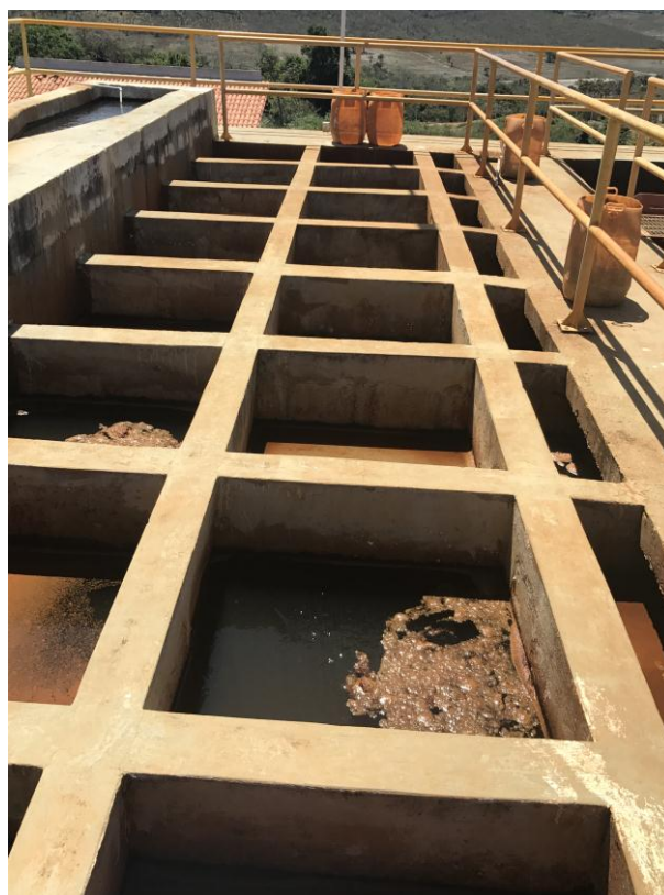
Figura 65– Floculadores– ETA Mulungu e Souto Soares
