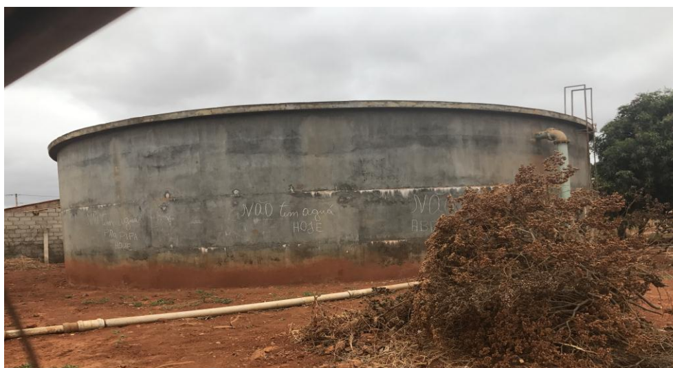
Figura 73 - Reservatório água tratada EMBASA– Sede/Mulungu do Morro
