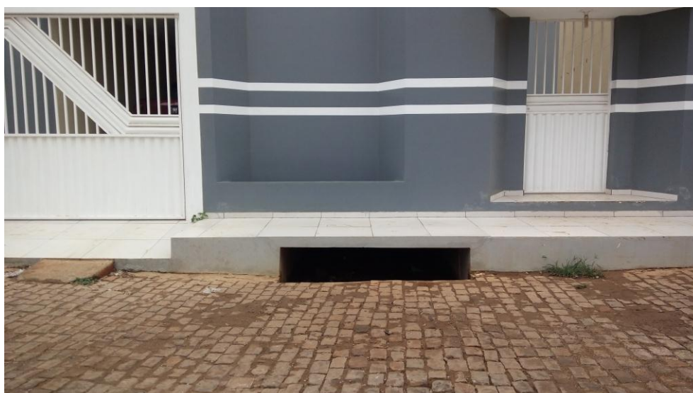
Figura 177 – Boca de lobo na Sede do município
