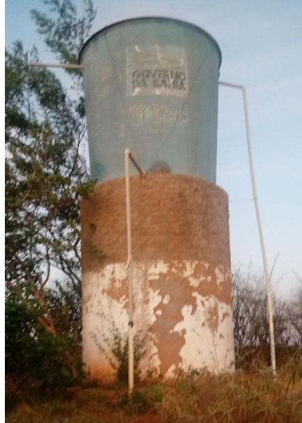
Figura 106– Reservatório de água salobra – Baixa Funda/Mulungu
