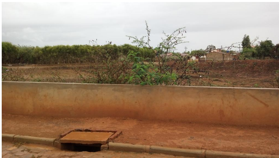
Figura 176 – Boca de lobo na Sede do município
