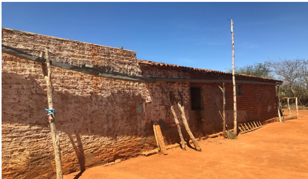
Figura 86 – Sistema rudimentar coleta de água de chuva – Alagadiço/Mulungu
