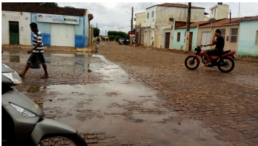
Figura 182 – Ponto de alagamento na Sede Municipal
